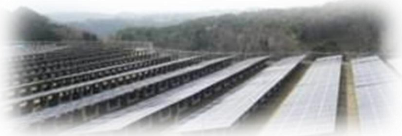
太陽光発電所
